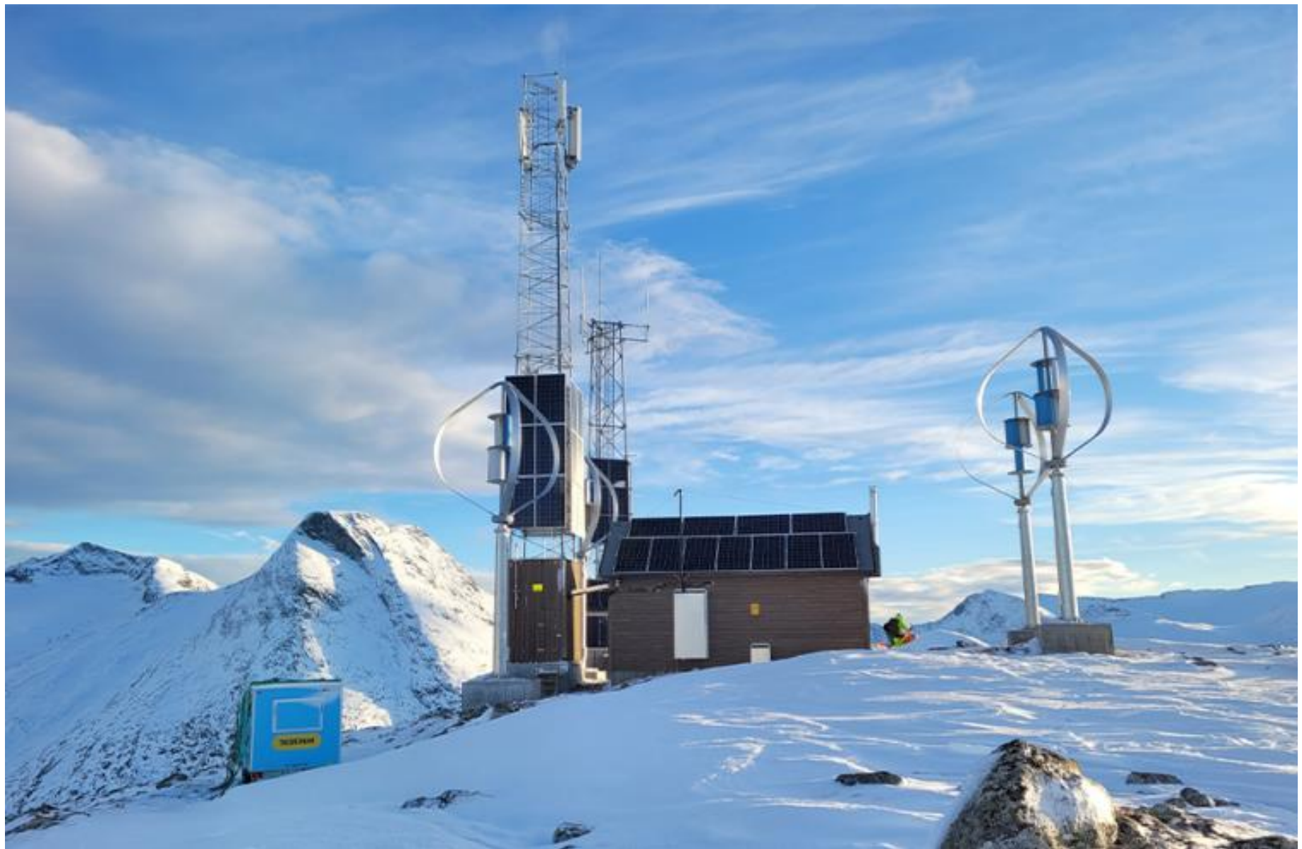
Installazione ibrida presso una stazione TLC in Norvegia
